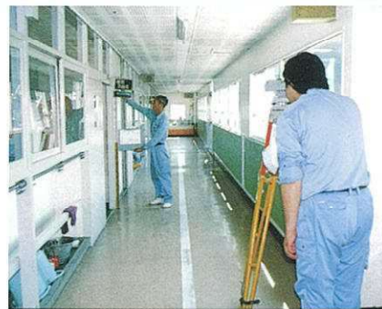
不同沈下測定
