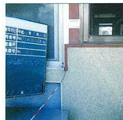
外壁のクラック測定
