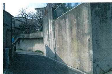
改修前の傾斜した擁壁
