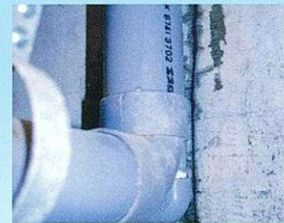
試薬による漏水確認調査
