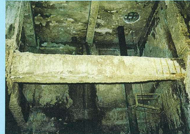
貯留ピット内の劣化調査
