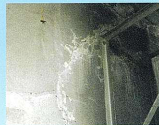
壁面の漏水確認調査
